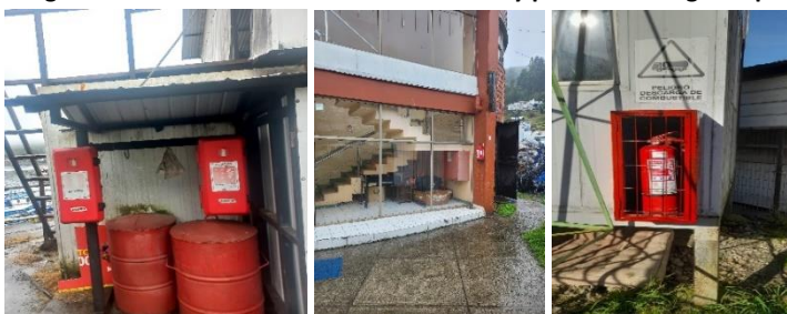
Figura N°9: Vistas localización de extintores y planillas de registro para extintores
