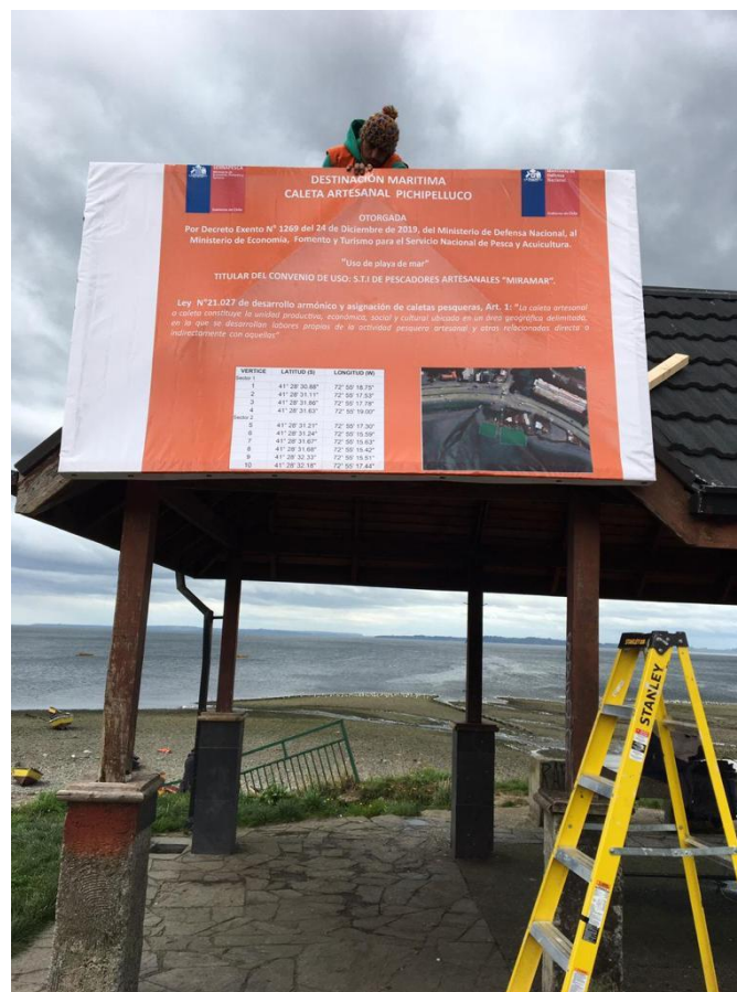
Figura N° 6 Vista de Letrero de Destinación Marítima
