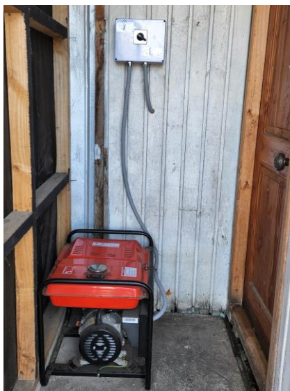
Figura N° 5: Vista Equipo Generador adquirido como soporte para el Sistema de Pesaje
