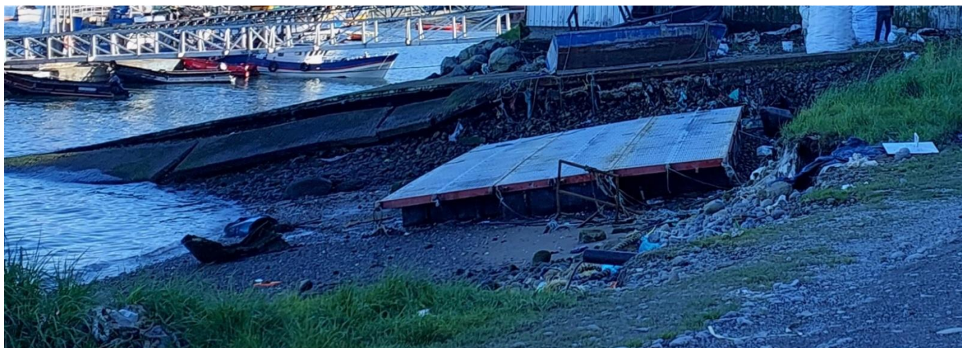
Figura N° 3: Vista rampa en mal estado, con problemas de rotura del concreto y deslizamiento hacia el costado.
