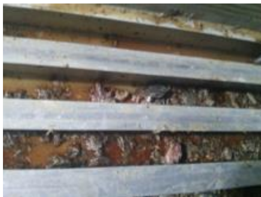
Imagem 4: Acúmulo de resíduos no assoalho do contêiner.
